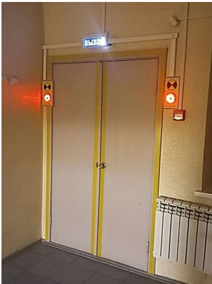
Фото 30. Запасной эвакуационный выход 1
