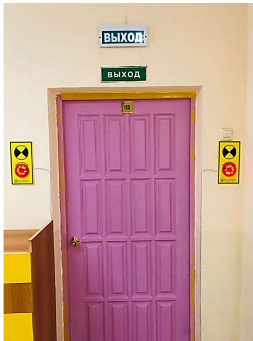
Фото 31. Запасной эвакуационный выход 2
