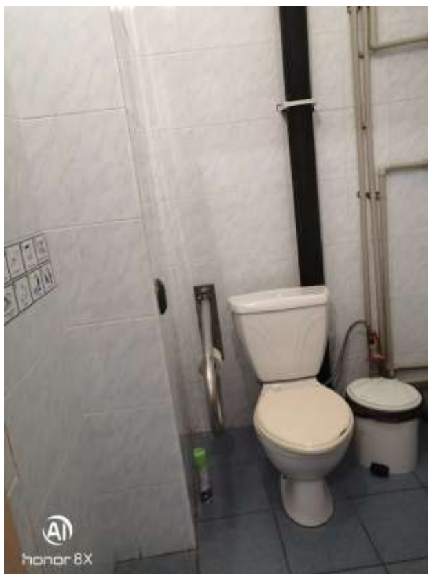
Фото 43. Туалетная комната на 2 этаже, унитаз, оборудованный поручнем для МГН
