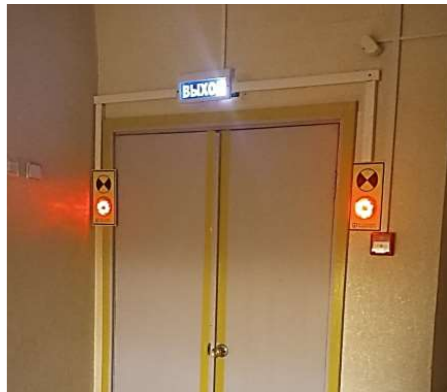
Фото 56. Световой указатель «Выход» (запасной эвакуационный выход)
